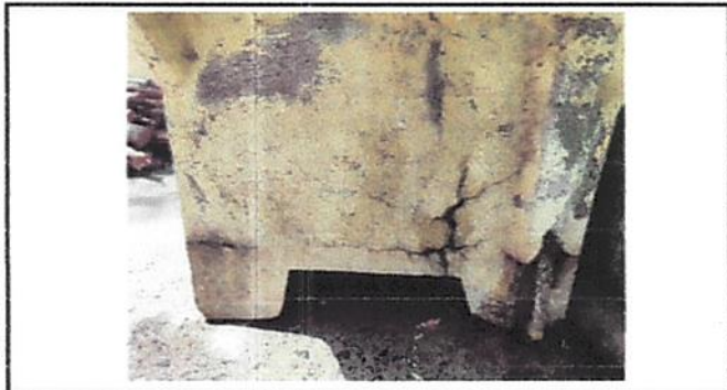
FOTO 3: DOS PILAS EN MAL ESTADO
