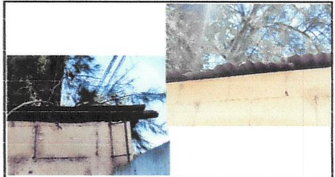
FOTO 2: TECHO DE COCINA EN MAL ESTADO
